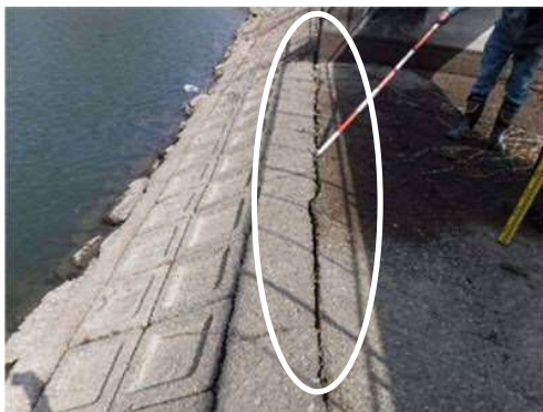
洪水吐流入部 ひび割れ
