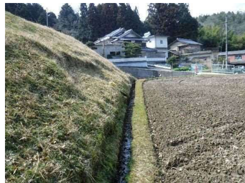
後法 はらみだし及び陥没
