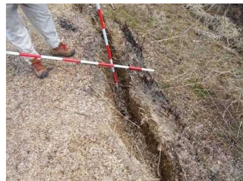
堤頂 ひび割れ
