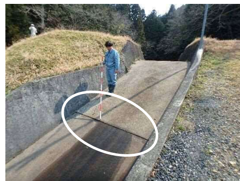
放水路部 漏水
