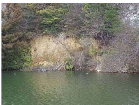
ため池周囲 土砂崩壊
