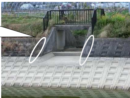
洪水吐(貯水池側より)
