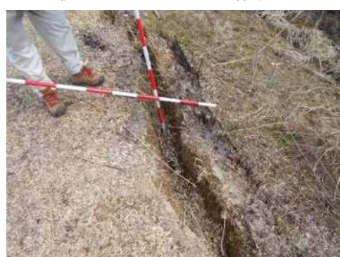
堤頂 ひび割れ
