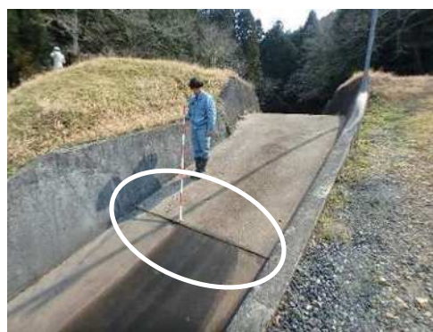
放水路部 漏水
