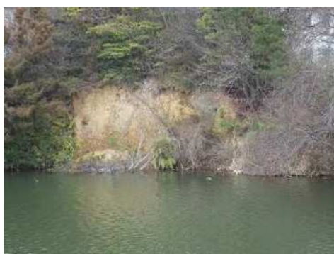
ため池周囲 土砂崩壊
