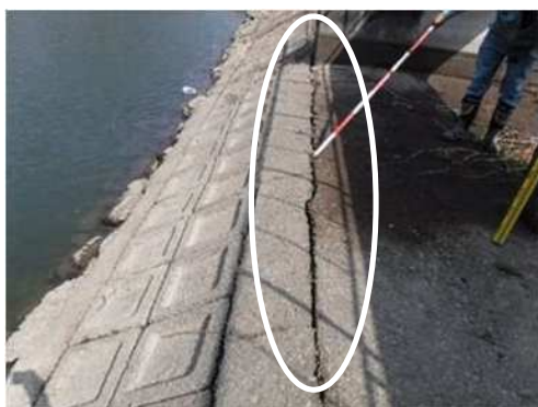
洪水吐流入部 ひび割れ
