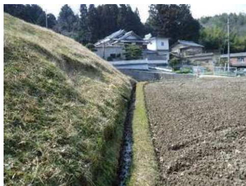
後法 はらみだし及び陥没
