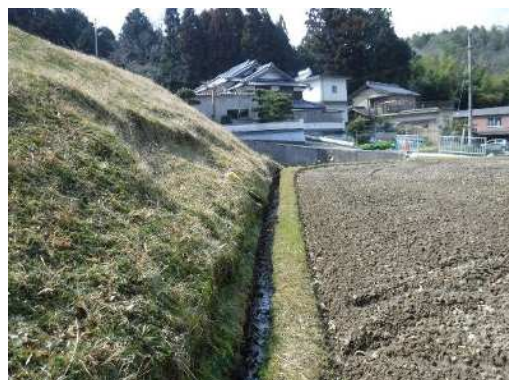
後法 はらみだし及び陥没
