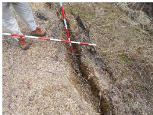
堤頂 ひび割れ
