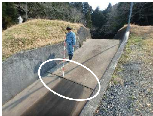
放水路部 漏水
