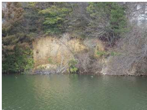
ため池周囲 土砂崩壊
