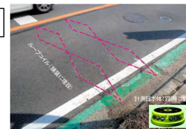
観測機器の設置状況
