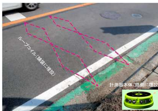
観測機器の設置状況
