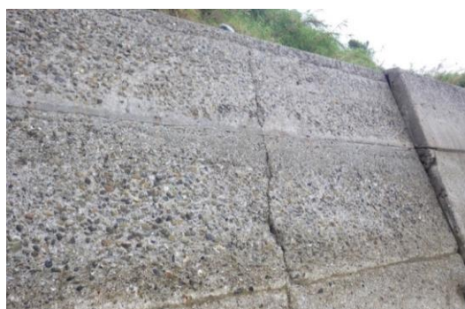
護岸に発生したクラック
