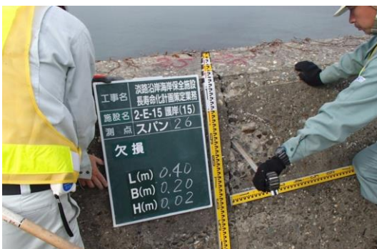
老朽化状況調査
