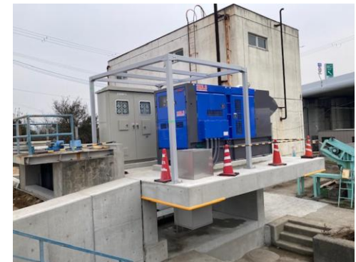
〔南あわじ市〕 志知川 (南) 排水機場
