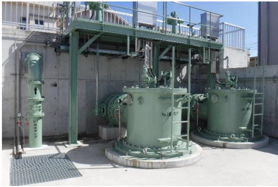
炬口ポンプ場（洲本市）
