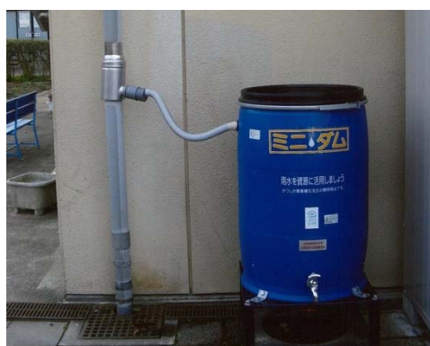
雨水貯留浸透（各戸）
