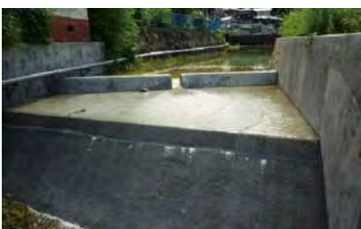
高砂市 ため池事前放流設備 (高砂市北浜町北脇 寺下池)
