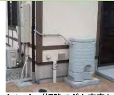
雨水タンク (姫路こども家庭センター)
