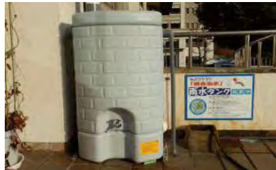
兵庫県 姫路庁舎雨水貯留タンク N=1基(200 リットル )(姫路市北条1-98)
