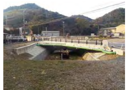
二級河川 大井川《西庄地区》 築堤・護岸・橋梁<平成26年度完成>
