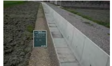
福崎町 川端雨水幹線 5.44 m 3 /sec(福崎町山崎地区)
