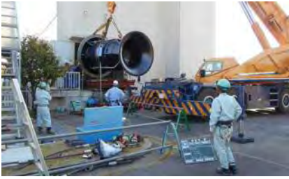
高砂市 天川ポンプ場 4.4 m 3 /sec × 2台(高砂市曾根町)
