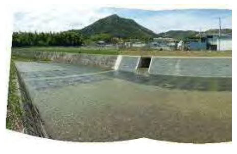
二級河川 天川《姫路市飾東町豊国》 平成26年 河川災害復旧事業
