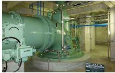
高砂市 天川第二ポンプ場 2.2 m 3 /sec(高砂市曾根町)
