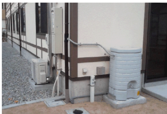
姫路こども家庭センターの雨水タンク
