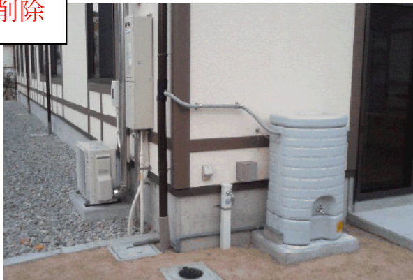
姫路子ども家庭センターの 雨水貯留タンク
