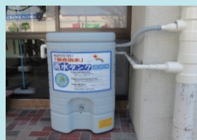
庁舎等に設置した雨水タンク
