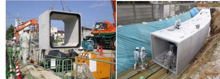
雨水管整備状況
