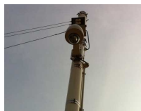
ため池の監視カメラの事例
