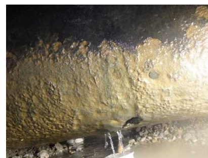
猪名川幹線漏水事故(R3.10.7)
