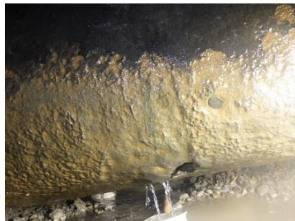
【猪名川幹線漏水事故(R3. 10. 7)】
