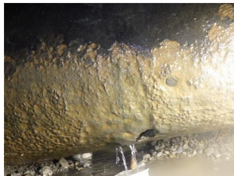
【猪名川幹線漏水事故(R3.10.7)】
