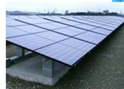
写真 1 6 太陽光発電施設の設置例
