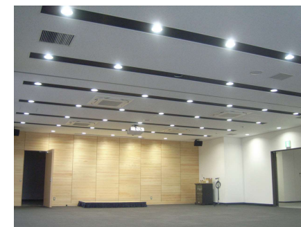
写真13 県有施設におけるLED照明器具設置の事例
