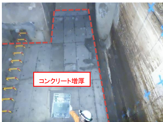
人孔内面のコンクリート増厚補強による 人孔耐震化(武庫川下流流域下水道)
