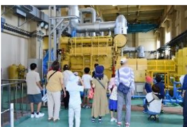
武庫川下流浄化センター
