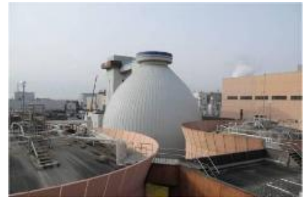
下水汚泥消化施設 （原田処理場）
