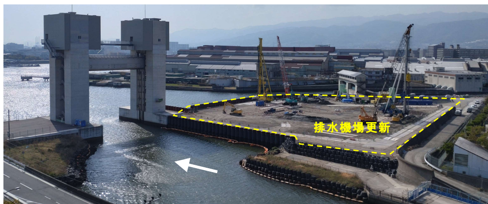
新川・東川統合排水機場（西宮市）
