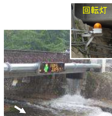
電光掲示板(甲橋) (増水時の状況)
