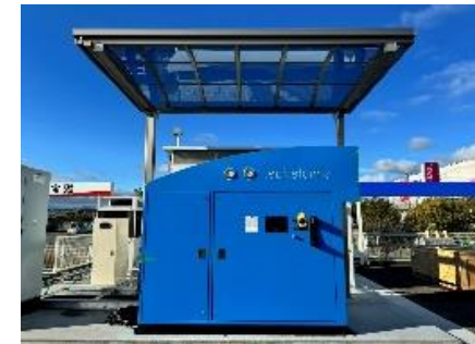
ネットテラス三木水素ステーション
