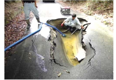
パイプライン破損による道路陥没 (断水・通行に支障)
