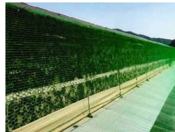
防鳥ネットを修繕した養鶏場
