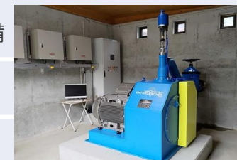
黒土川小水力発電(R5.3稼働) (宍粟市千種町黒土地区)
