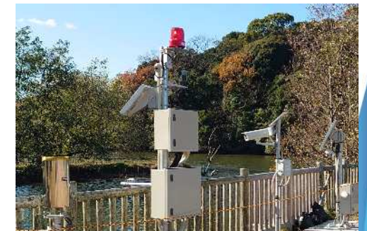
ICTの活用による遠隔監視 (淡路市)
