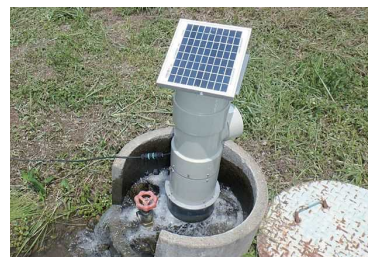
遠隔操作型自動給水栓（たつの市）
