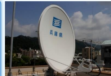
▲衛星アンテナ (災対センター屋上)
