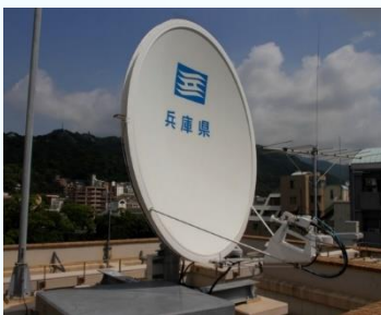
▲衛星アンテナ (災対センター屋上)
