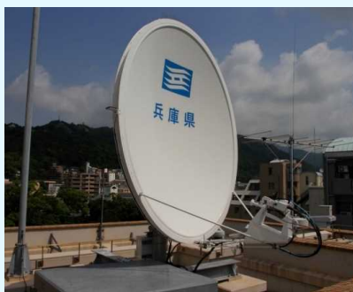
▲衛星アンテナ (災対センター屋上)
