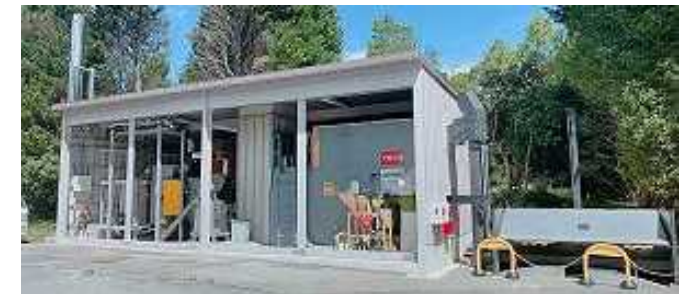
木質バイオマスボイラー
