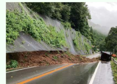
国道178号 台風豪雨による土砂崩れ
