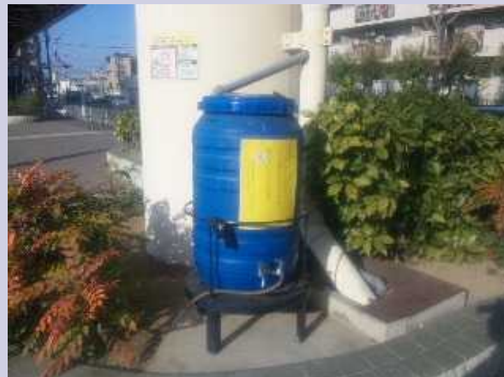
鉄道駅前の連絡通路下に設置された 雨水貯留タンク(川西市)
