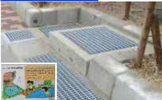
【公園貯留】 もすりん橋公園(尼崎市)
