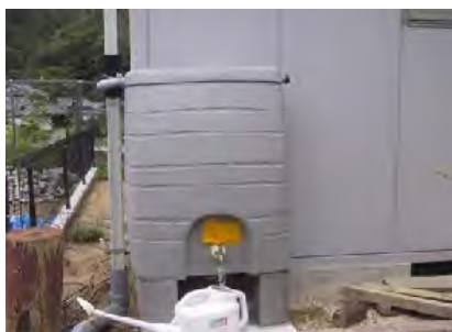
写真 2.2.10 雨水貯留タンク各戸貯留
