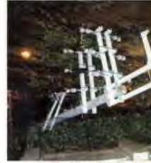
道路崩壊で倒れた電柱（19日午前11時ごろ、神戸市東灘区東灘町）
