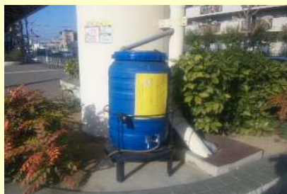
雨水貯留タンク(川西市)
