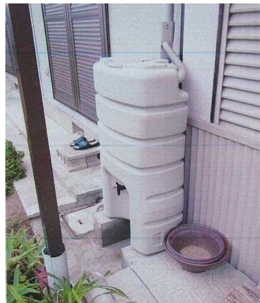
雨水貯留タンク設置例（宝塚市）
