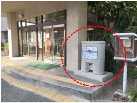
雨水貯留タンク（上：三田庁舎、下：西宮庁舎）
