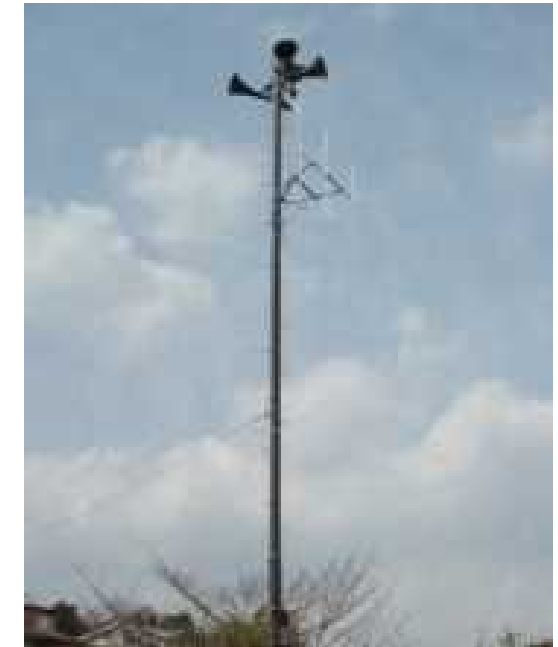
河川や港湾の親水施設等 付近に防災スピーカーを整備
