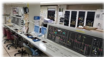
中央監視制御設備(県庁本庁舎)
