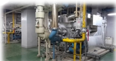
冷温水発生機(県庁本庁舎)
