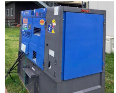
(非常用自家発電設備)
