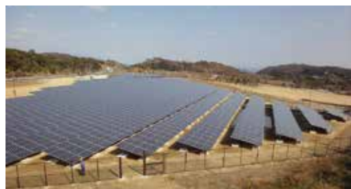
▲住民参加型太陽光発電所
