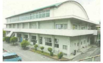
〈体育館屋根破風の破損〉
