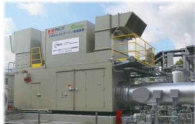
水素コージェネレーション実証設備
