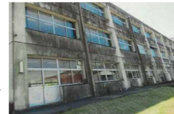
〈外壁塗装の黒カビによる劣化〉
