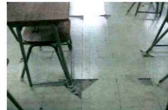
〈教室床(Pタイル)の破損〉
