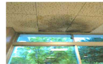
〈天井の雨漏り〉
