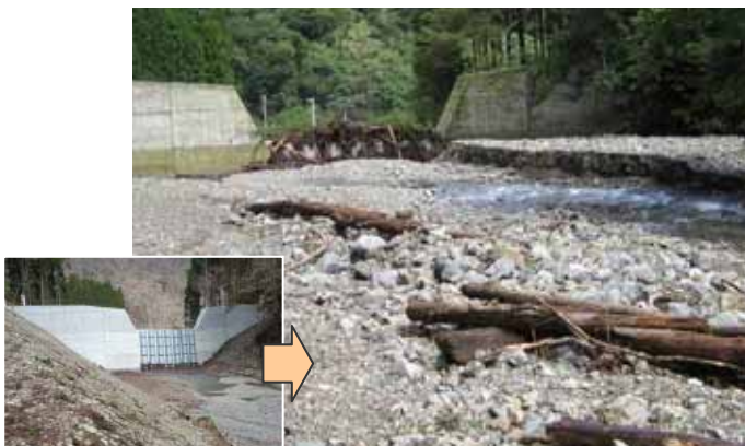
平成23年台風第12号による約3,000m 3 の土砂・流木を捕捉し、土砂災害を未然に防止
