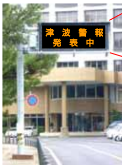
大型道路情報版[既設]への 津波警報等の表示
