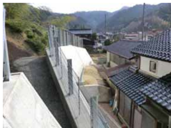
人家裏のがけ崩れ対策施設(がけ崩れを受け止め、人家を保全)
