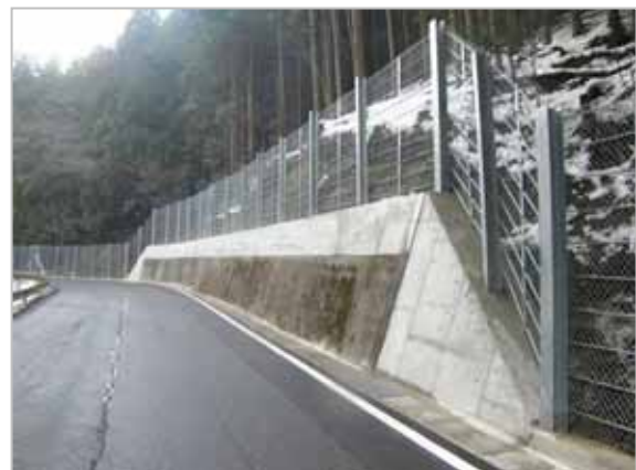
落石防止柵(国道427号:丹波市)
