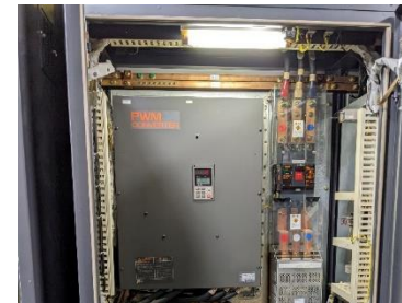
床機構制御盤
