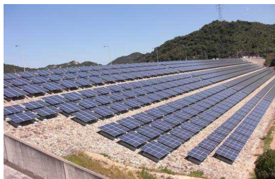
【権現ダム太陽光発電所】
