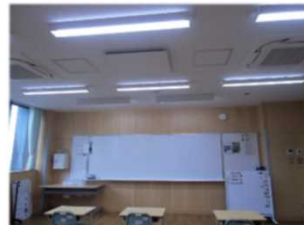
普通教室の空調室内機とLED
