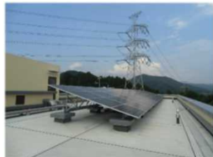
太陽光発電設備
