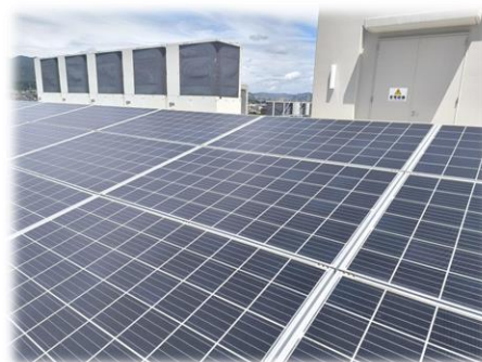
太陽光発電設備
