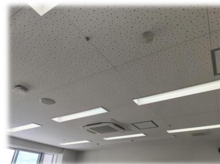
普通教室の空調室内機とLED
