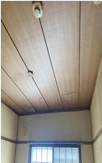
⑦雨漏り(101号室)
