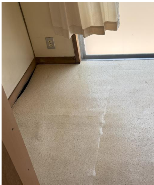
床の経年劣化
