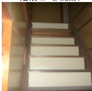
階段 ※一部破損あり
