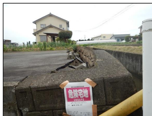
危険宅地と判定された宅地
