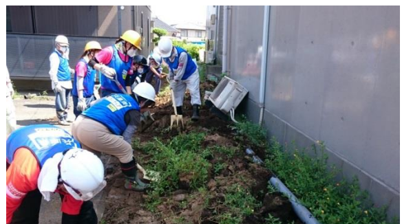
益城町の被災民家での災害ボランティア
