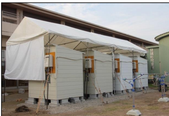
益城町保健福祉センターに設置されたシャワールーム (平成 28 年 6 月 9 日(株)ノーリツ発表資料より)
