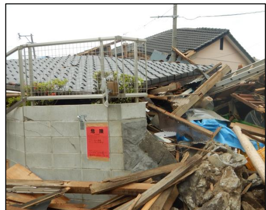
危険と判定された建築物
