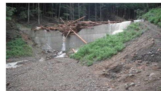
【流木を補足した治山ダム(丹波市)】
